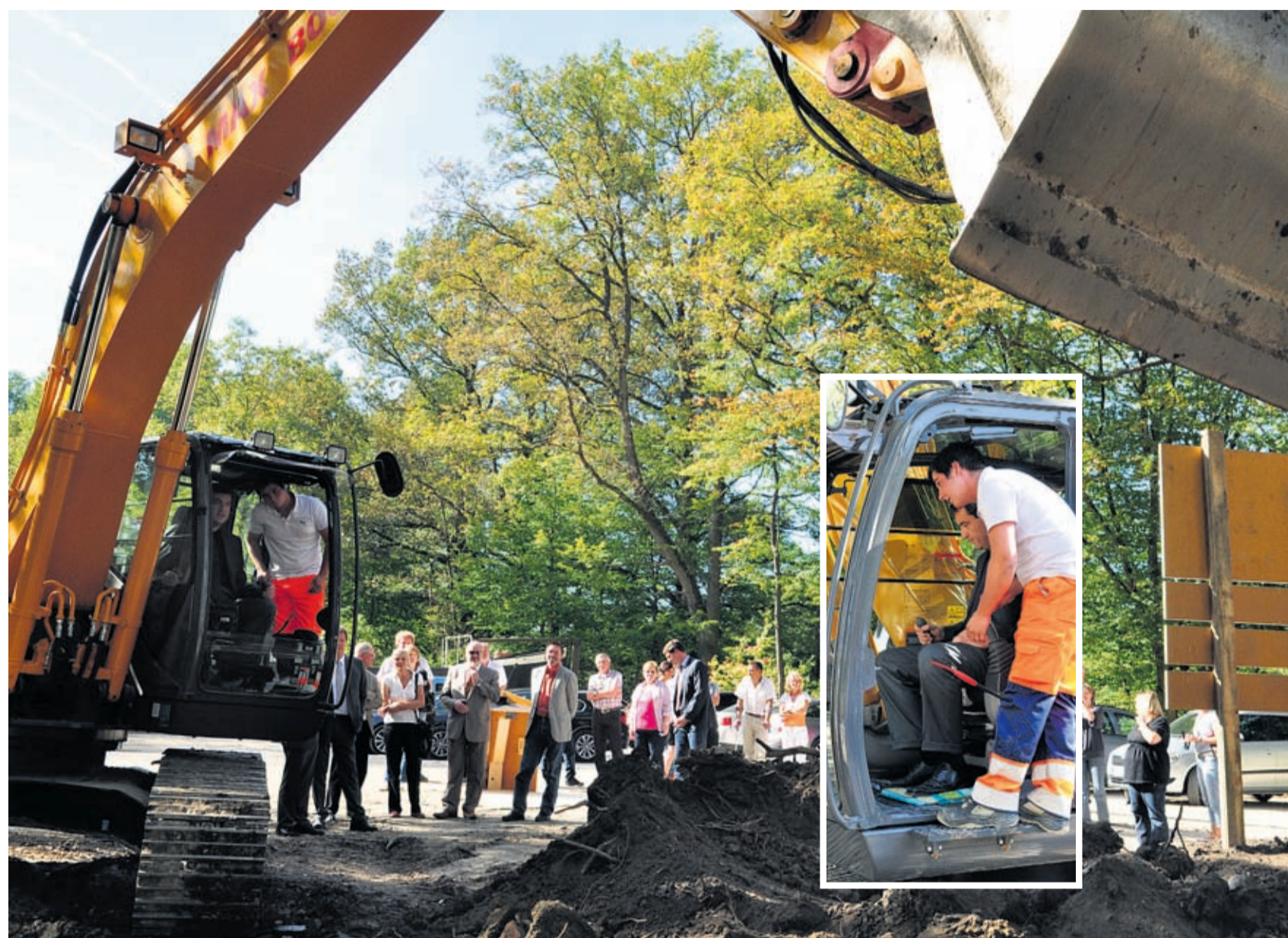
Umweltminister Dr. Markus Söder vollzog mit dem Bagger den ersten Spatenstich für die Sanierung des 2. Bauabschnitts am Dörlbacher Einschnitt. Fotos: Märtl
